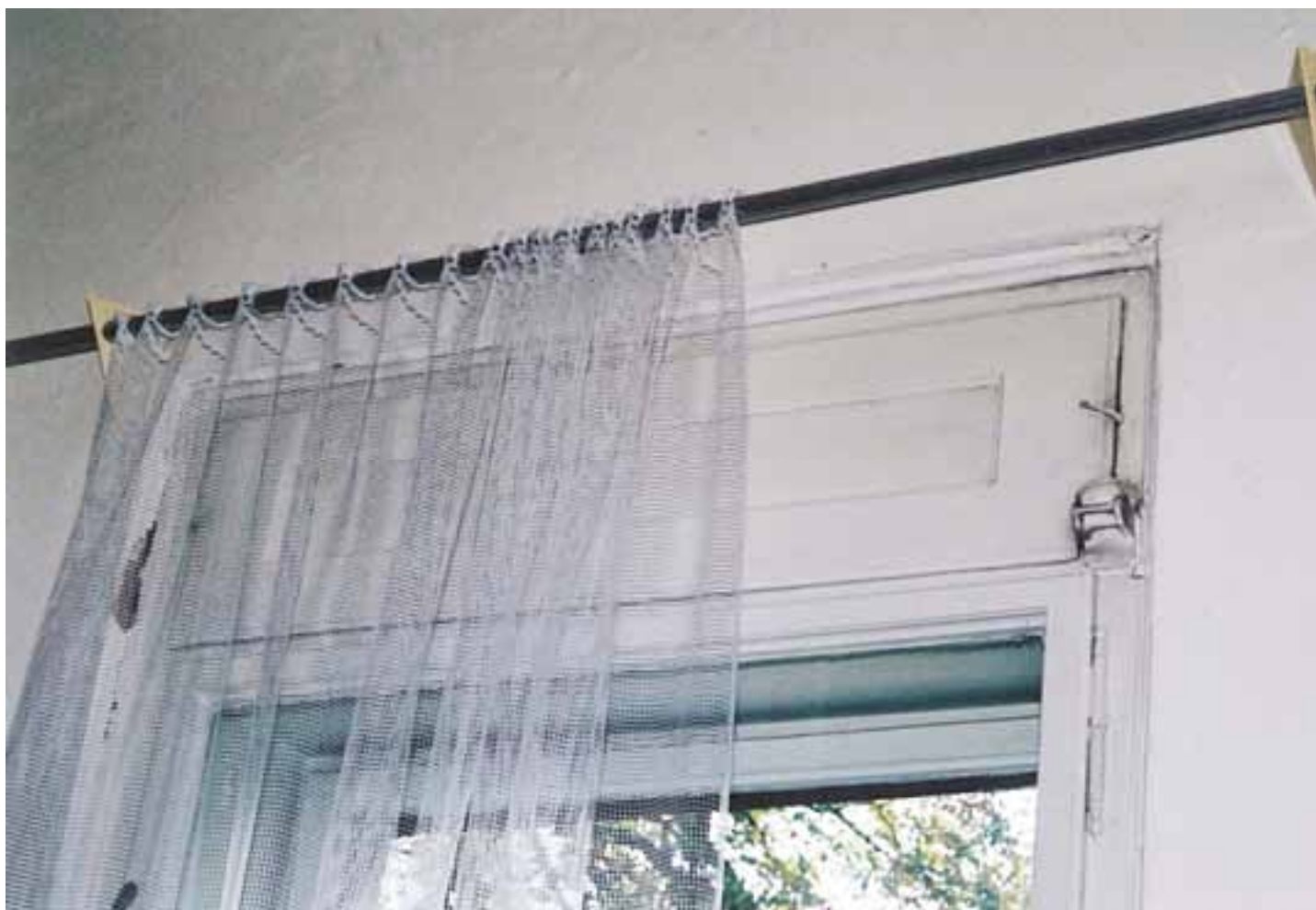
přízemí (m.č. 109) - detail krytu zavinutých vnějších dřevěných rolet; detail dveřní kliky na toaletu
