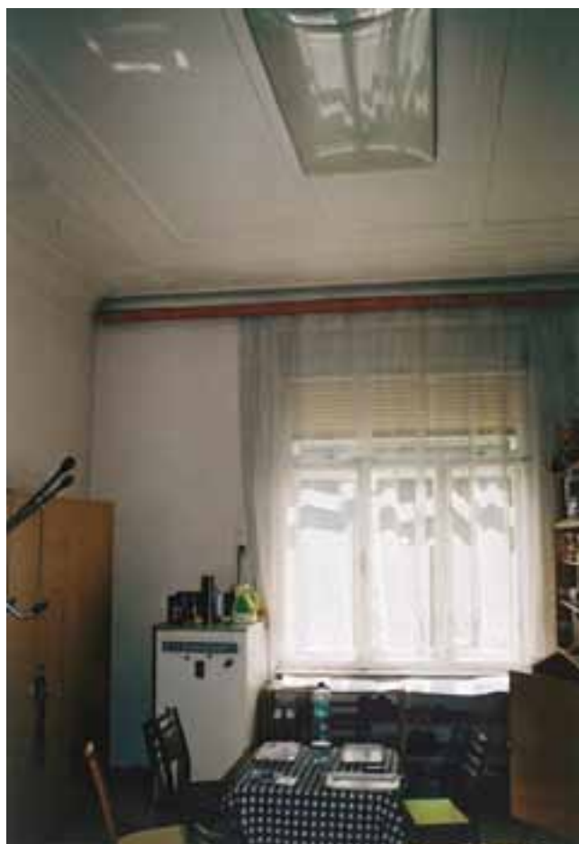
denní místnost učitelek a personálu v přízemí (m.č. 108); detail štukové výzdoby stropu
