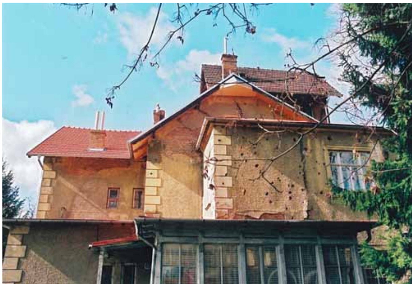
severovýchodní průčelí vily se stopami po střelbě (?) v omítce
